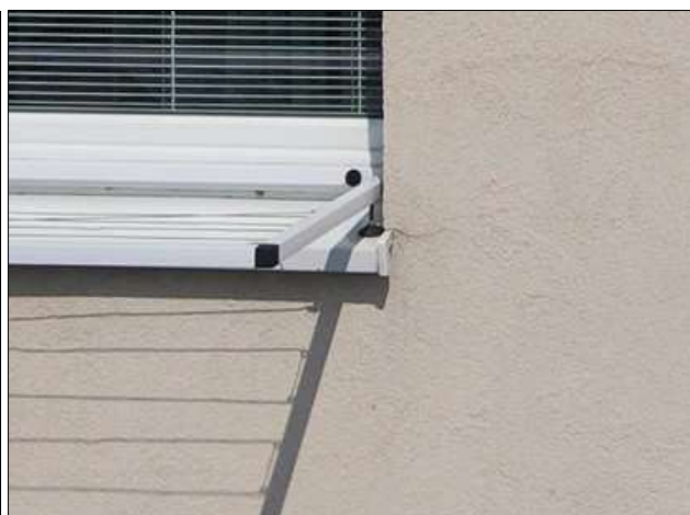
/Foto 15/ Příklad krátké horizontální trhliny ve výšce parapetu
