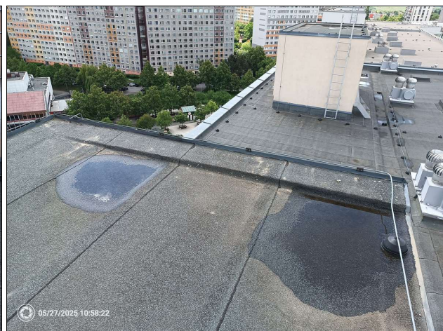
/Foto 6/ Kaluže na střechách strojoven
