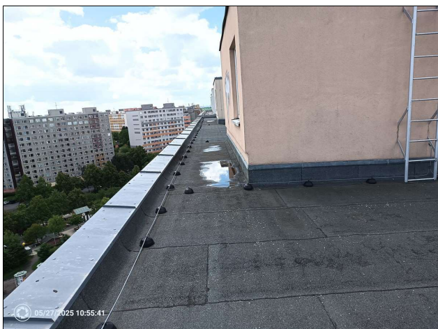
/Foto 5/ Kaluže za strojovny výtahů
