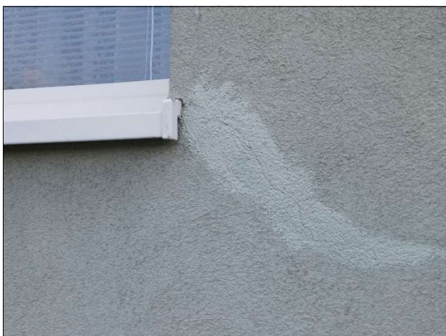
/Foto 9/ Příklad neúspěšně opravené diagonální trhliny vycházející z rohu parapetu
