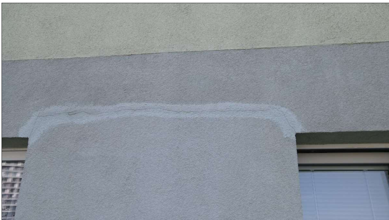
/Foto 11/ Příklad neúspěšně opravené horizontální trhliny propojující nadpraží oken
