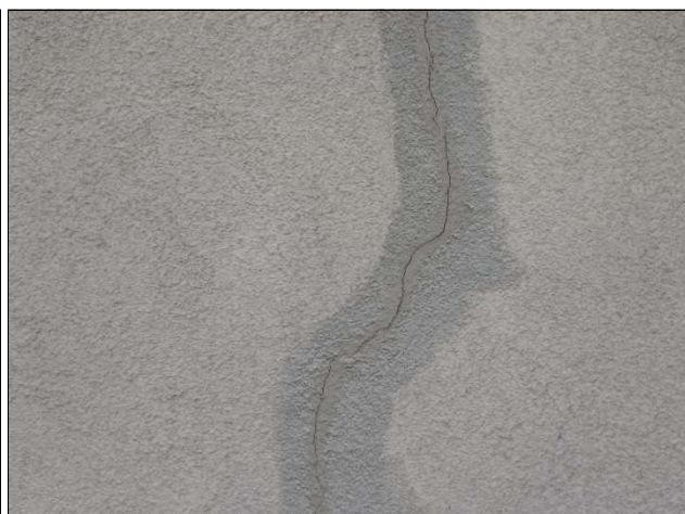
/Foto 10/ Příklad neúspěšně opravené vertikální trhliny v ploše fasády mezi okny
